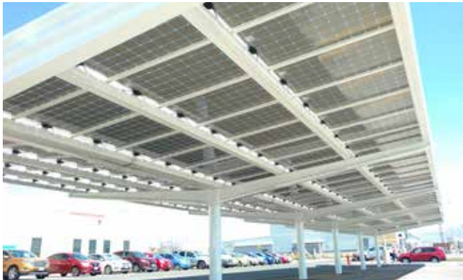
Estacionamiento Solar LALA, Torreón, Coah. | Potencia de 106.56 kWp
