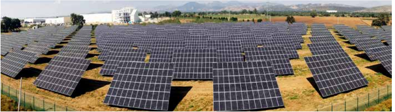
Parque Solar, México | Potencia de 3 MWp
