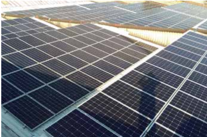
Calzado Van Vien, Toluca, Edo. de México | Potencia de 499.8 kWp
